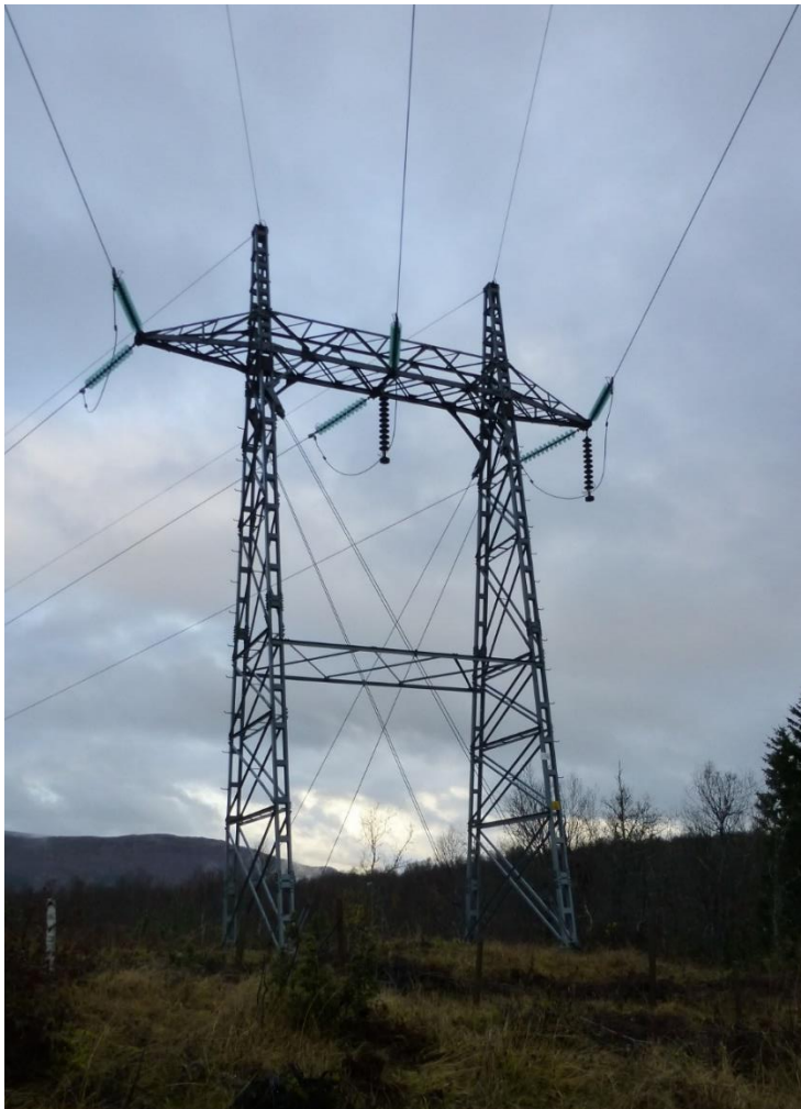
Figur 5-20. Forankringsmaster på de fire parallelle ledningene som går ut fra koblingsanlegget ved Straumsmo kraftstasjon. Ledningene har standard portalmaster av stål.
